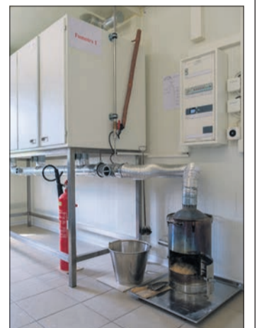
Les quatre fumoirs installés à Forel ont été créés sur mesure. Ils permettent de garantir un haut niveau de sécurité, mais aussi le goût fumé si singulier
