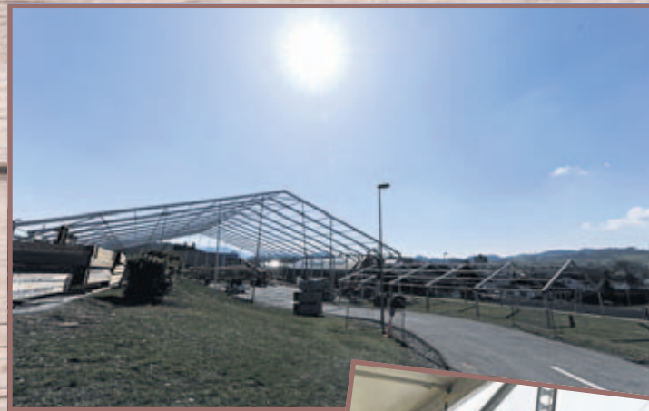
Le montage de la structure sous un soleil printanier Un savoir-faire indéniable pour un décor provisoire en dur
