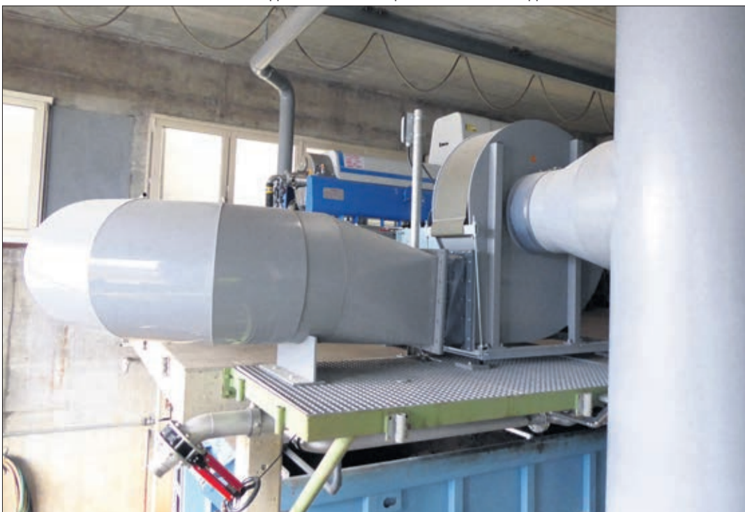
Les ventilateurs suppriment des odeurs parfois difficilement supportables
